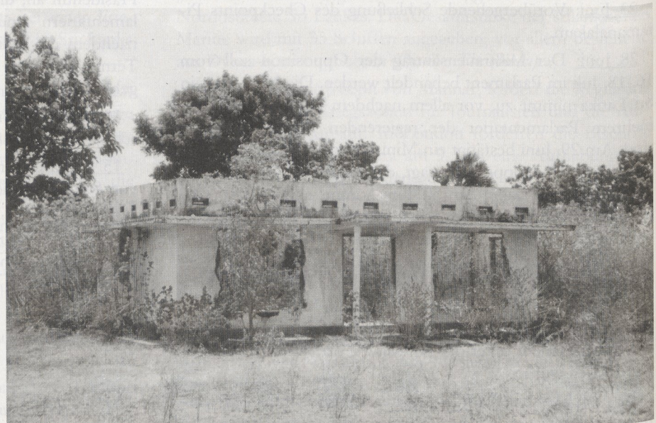
Zeichen des Krieges: Zerstörtes Haus im Trincomalee Distrikt (Foto: Benedikt Korf)
